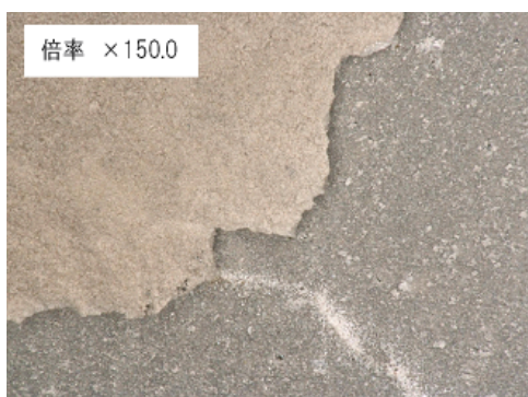
センサー素子表面にクラックが発生した例
